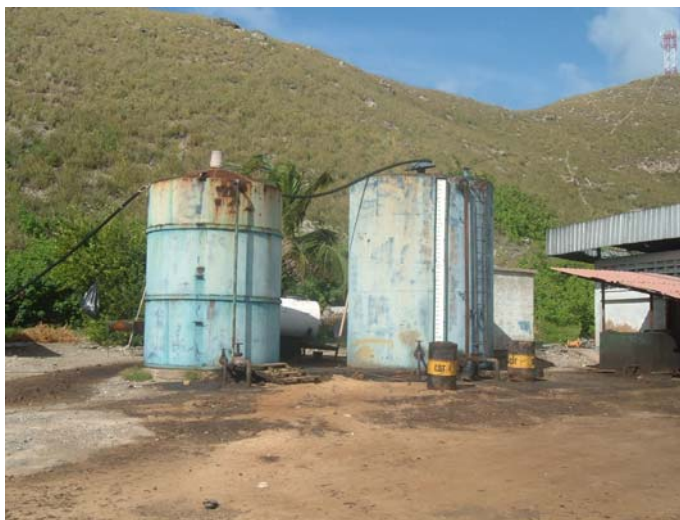
Figura B6. Tanques para el almacenamiento del combustible requerido en la operación de los generadores.
