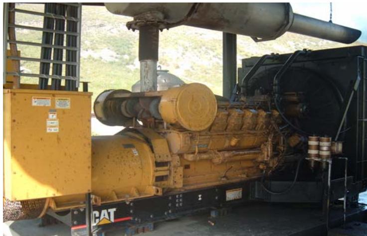
Figura 23. Generador Eléctrico Caterpillar Modelo 3512.
