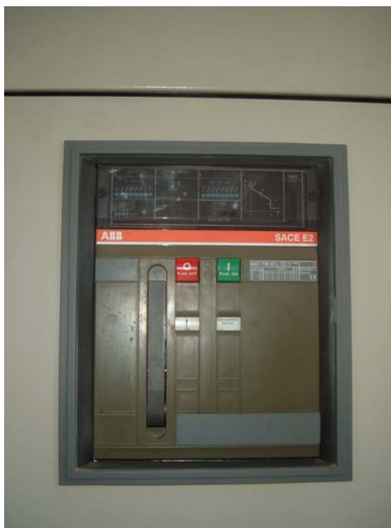
Figura B5. Sistemas de protección colocados en la barra de generación.
